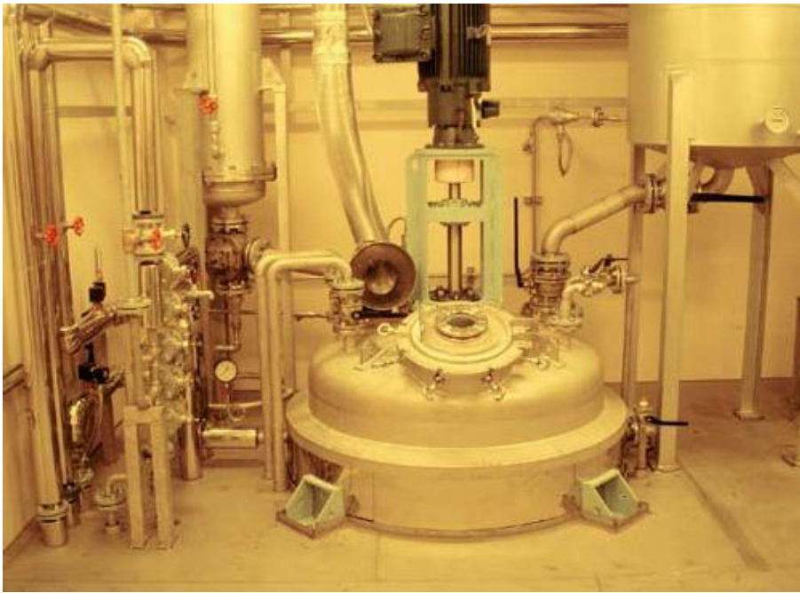
紫外線をカットする特殊な照明下にある反応釜
